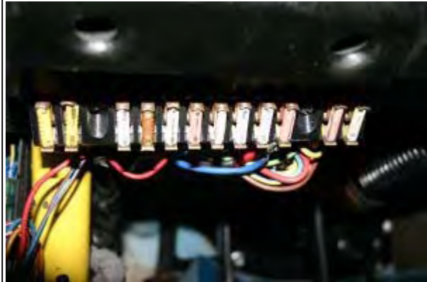
Pilla bort säkringen till bränslepumpen.
