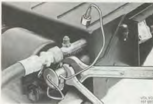
Bild 30. Demontering av expansionsventil med två nycklar
