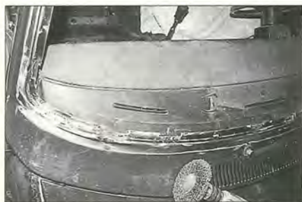
De bevestiging van de sierstrip van de voorruit is extreem roestgevoelig.
