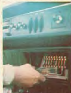
Bra detalj 1: Säkringarna under panelen.
